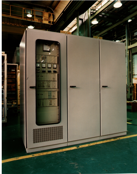
Figura 2 – Painel de proteção e excitação de geradores
